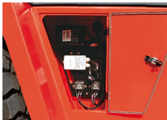
Cabine elétrica independente
